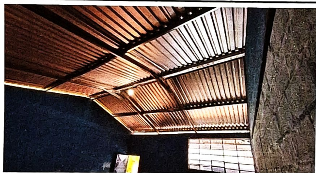
Foto 3: Sustrucción de vigas y costaneras en mal estado de las tres aulas
