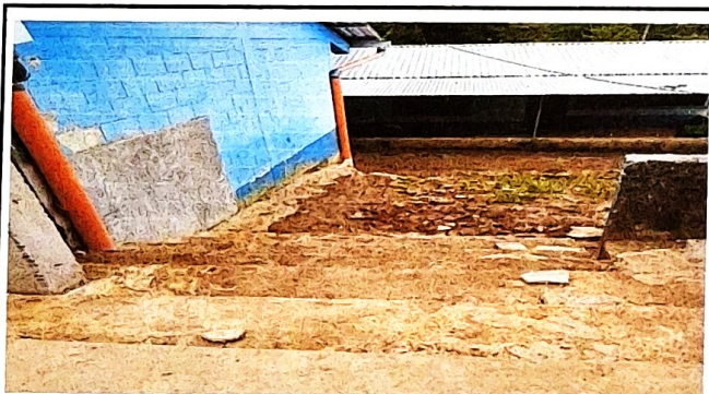
Foto 5: Mantenimiento a pared y gradas ya que se encuentran en mal estado
